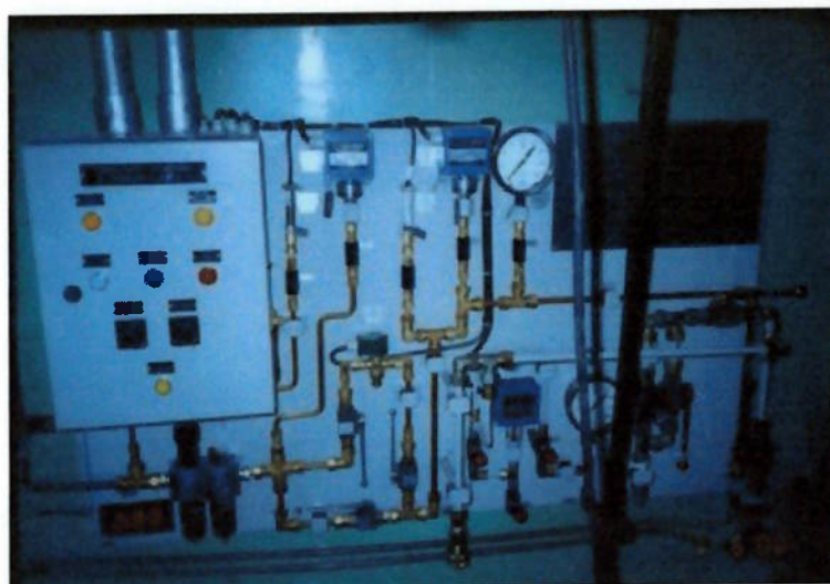
Fig 2.10 – Quadro Óleo Pneumático de Controle Local
